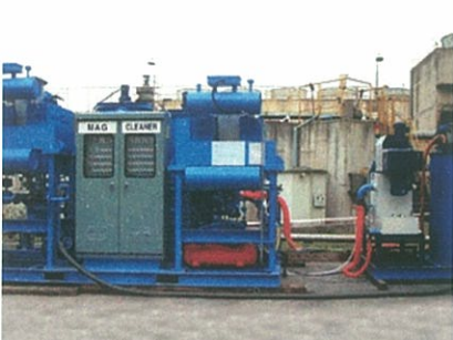
폐수처리 공정 Wastewater
